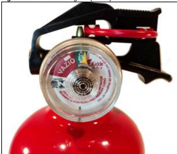
Figura 5 - Extintor Carregado (Cheio).
