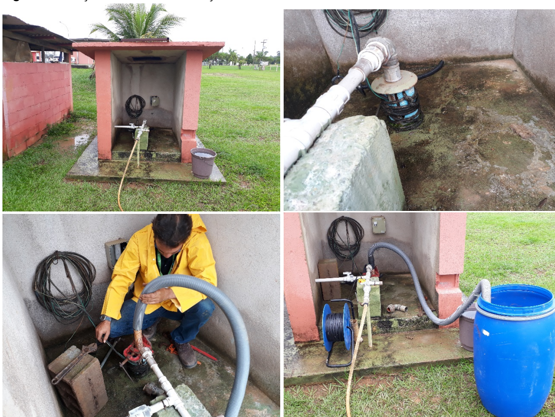
Figura 5 – Poço tubular da subestação Vilhena.
