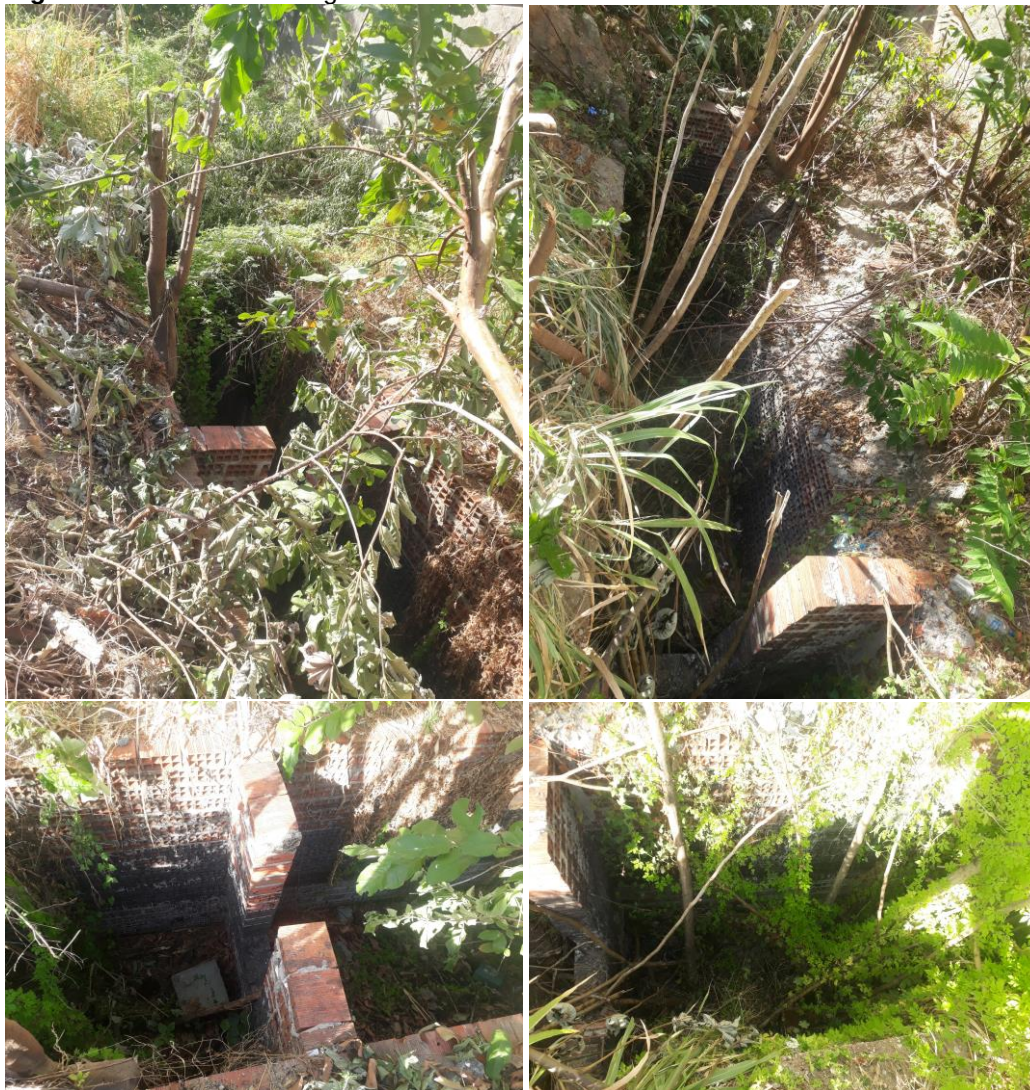
Figura 4 – Estrutura de Esgotamento Abandonada.
