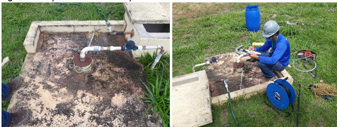
Figura 5 – Poço tubular da subestação Pimenta Bueno.
